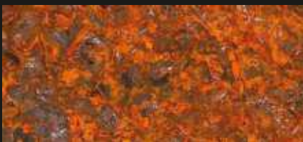
Korozyon koruması işlemi olmadan
